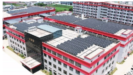
HSD浙江工厂太阳能发电系统
