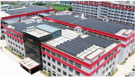
HSD浙江工厂太阳能发电系统
